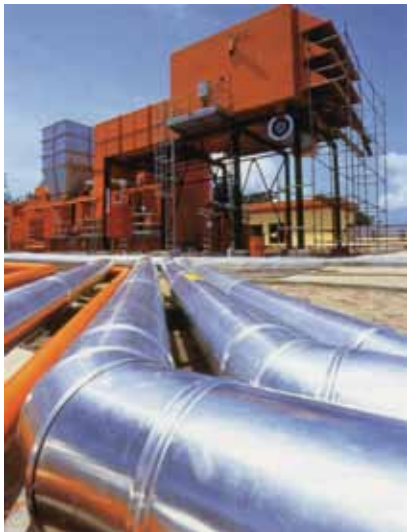
La centrale électrique de Ciprel
